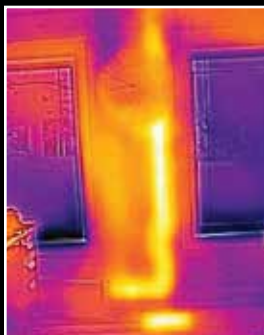
Warme leiding in muur
